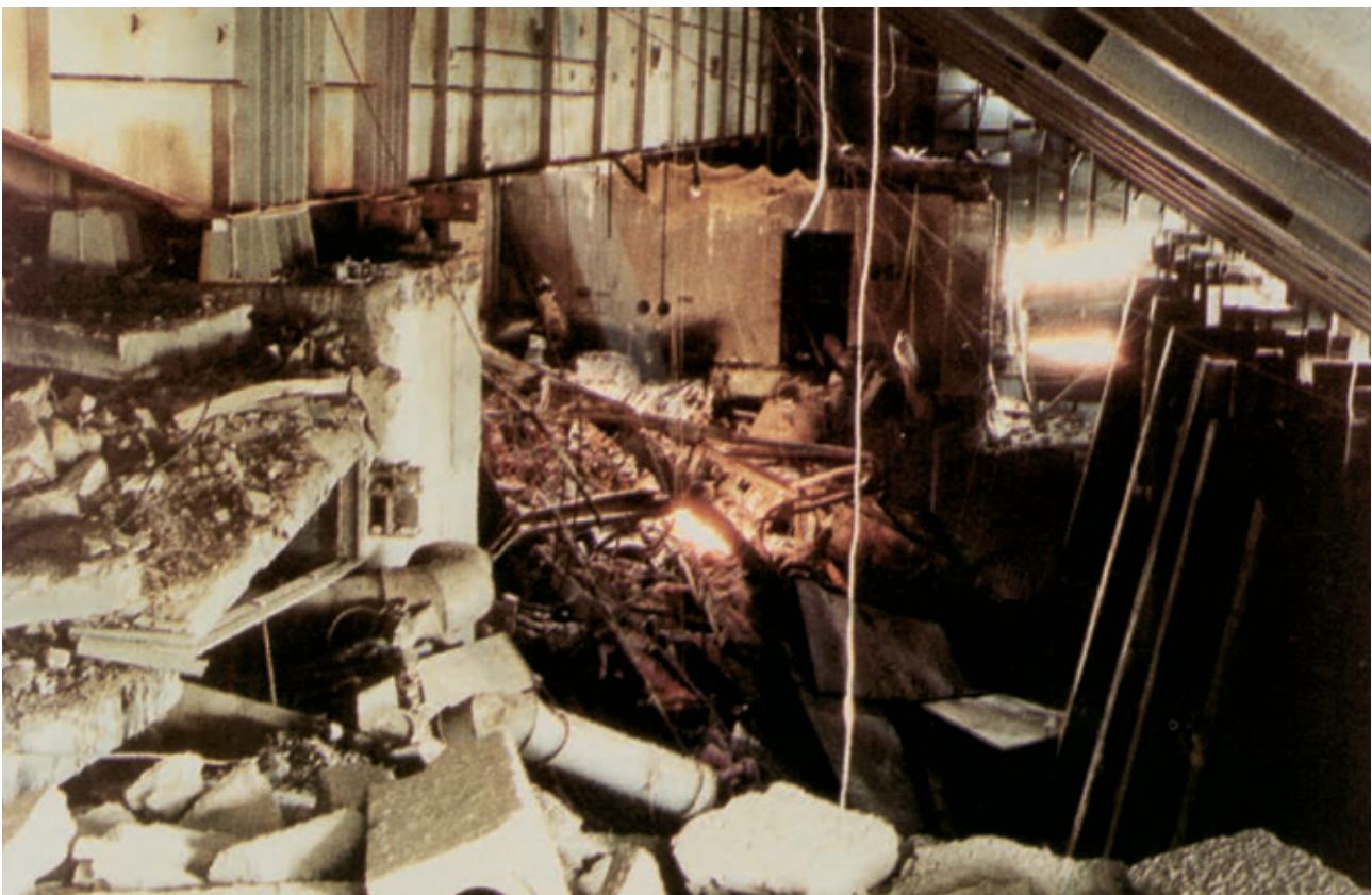
Blick in das Innere des zerstörten Reaktorgebäudes.
