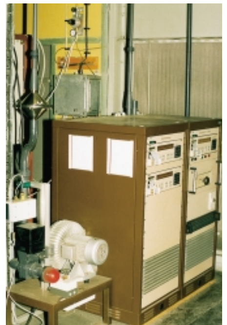
Abb. 34: Abluftmessung – Schacht Bartens- leben
