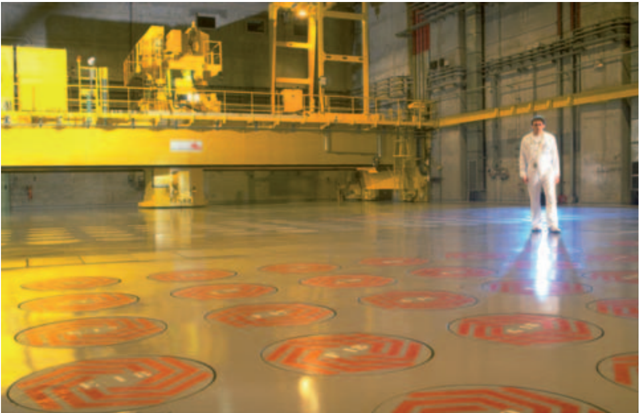
Kokillen-Lager bei der COGEMA in Frankreich. Die hochradioaktiven, zylinderförmigen Glaskokillen befinden sich in senkrechten Bohrungen unter den gekennzeichneten Flächen.
